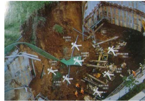
川崎市野川健康センター建設土留崩壊 (1989.5) 死亡:5名
